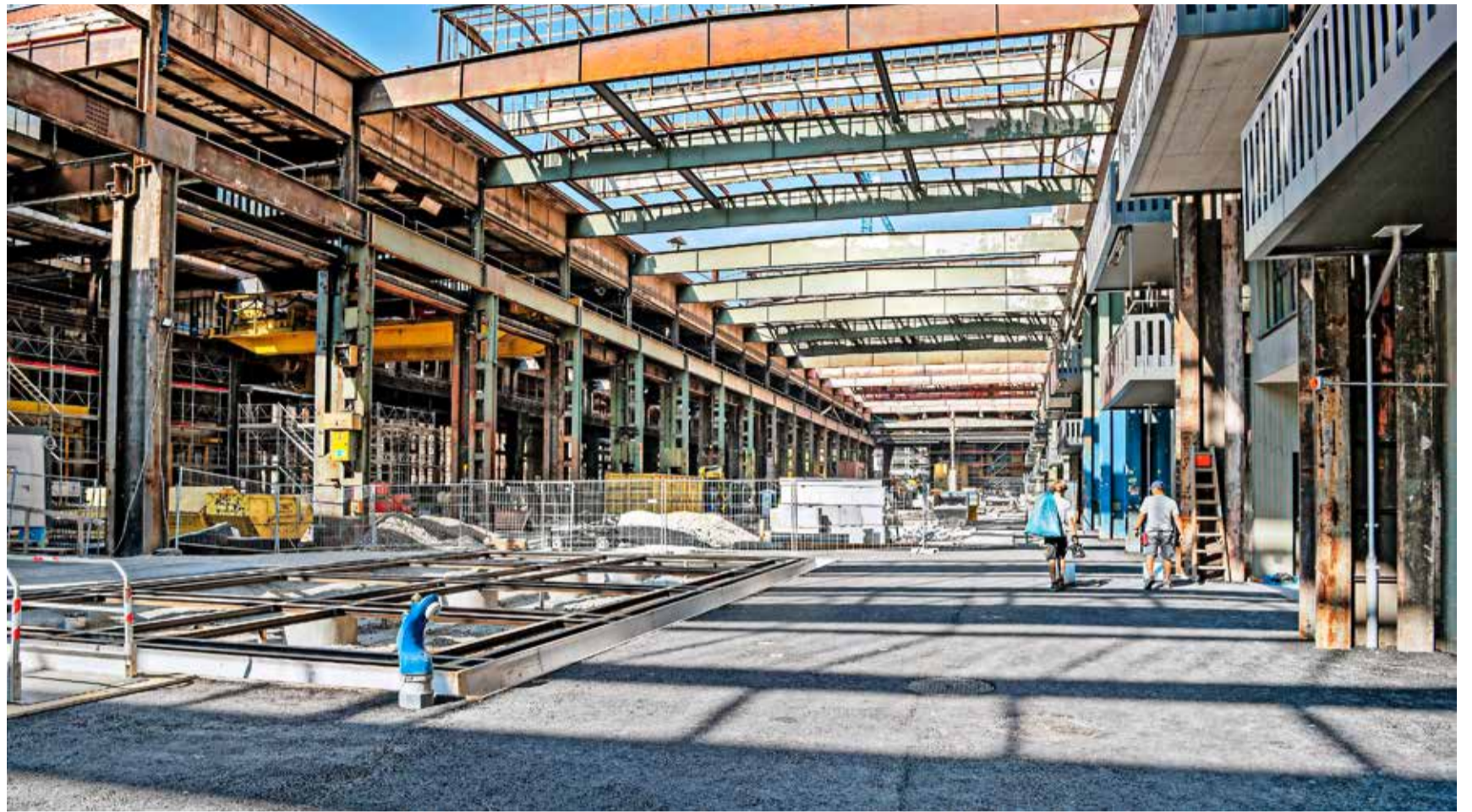
Wo im Sommer 2022 eine Kindertagesstätte eröffnet werden soll, ist heute noch eine Baustelle beim neuen Stadtquartier Stahlgiesserei.
