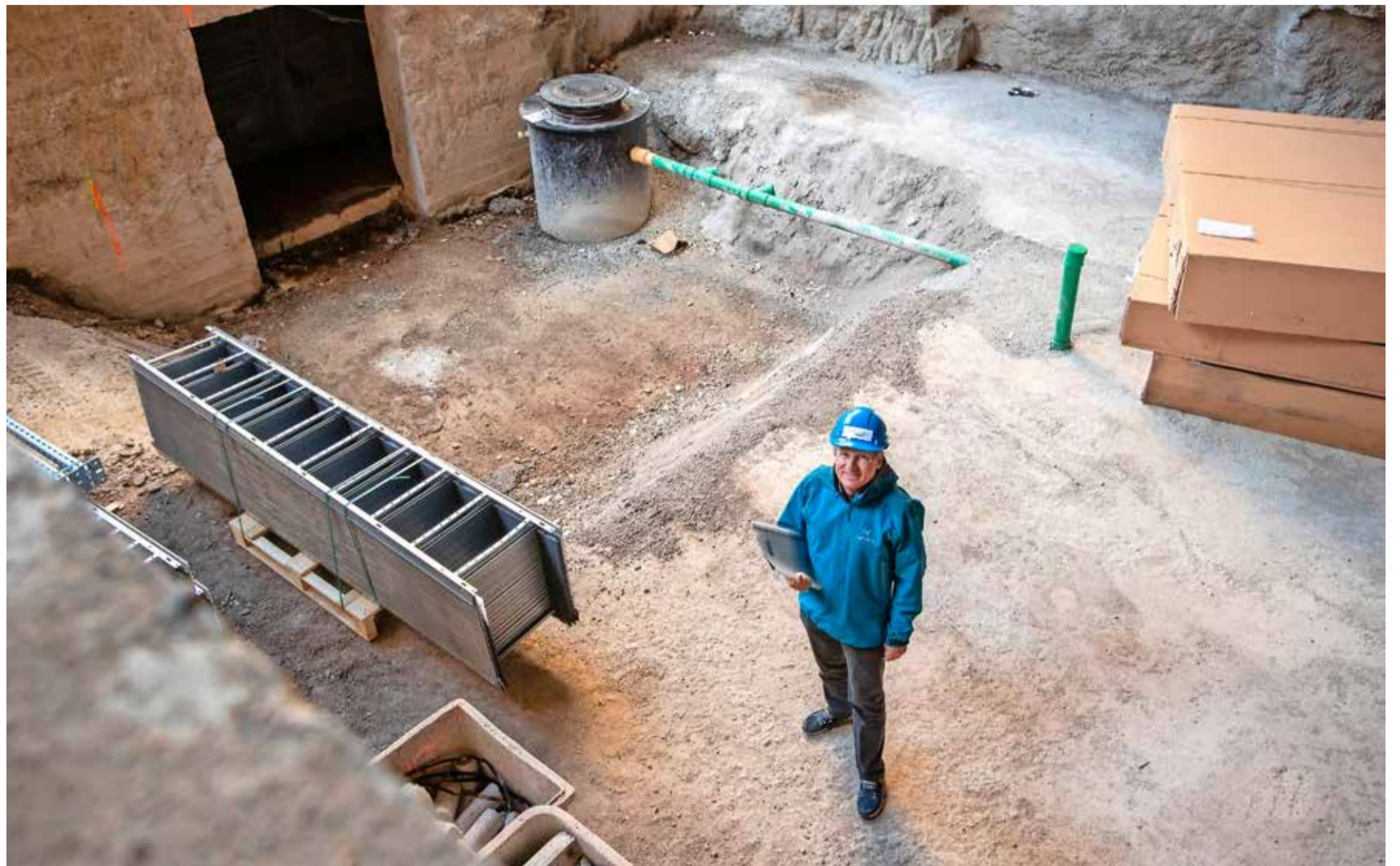
Der Präsident der Rheumaliga Schaffhausen, Thomas Stoll, zeigt die für die Technik vorgesehene Aushubgrube im ersten Untergeschoss. Mit den Bauarbeiten des neuen Warmwasserbeckens wurde im März 2021 in der Stahlgießerei begonnen.
