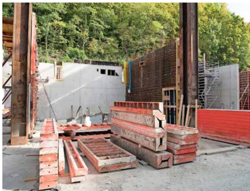
Hier werden bereits die ersten Wohntürme hochgezogen. Insgesamt sind acht davon im Osten des Areals geplant.
