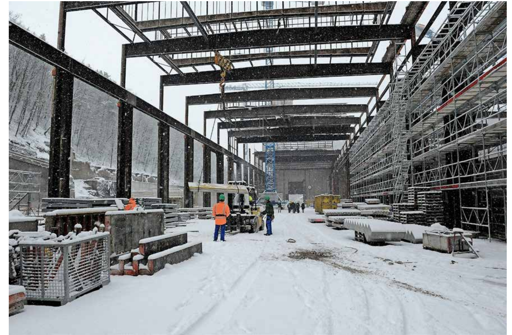
Schneeflocken wirbeln in der einst grossen Werkhalle der alten Georg-Fischer-Stahlgiesserei im Mühlental umher. Das Stahlträgergerippe ist nun ganz freigelegt, auf der linken Seite sind im Hintergrund – noch niedrig – die Betonwände der ersten Hochhäuser sichtbar.
